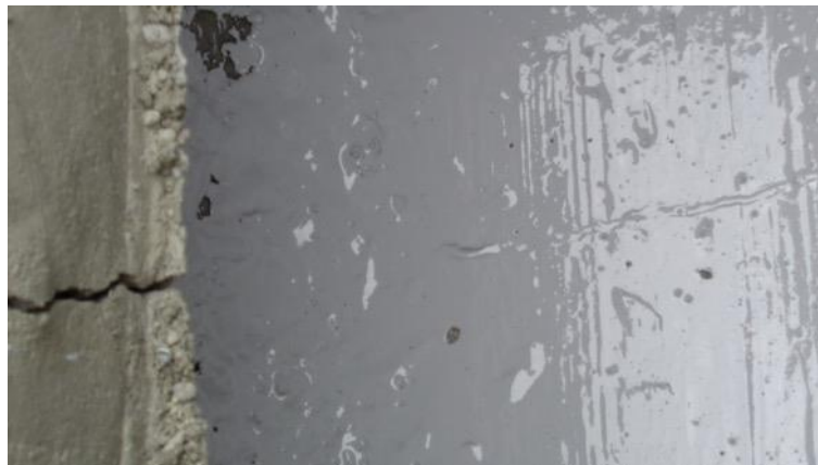
Résultat du produit appliqué partiellement sur la fissure
