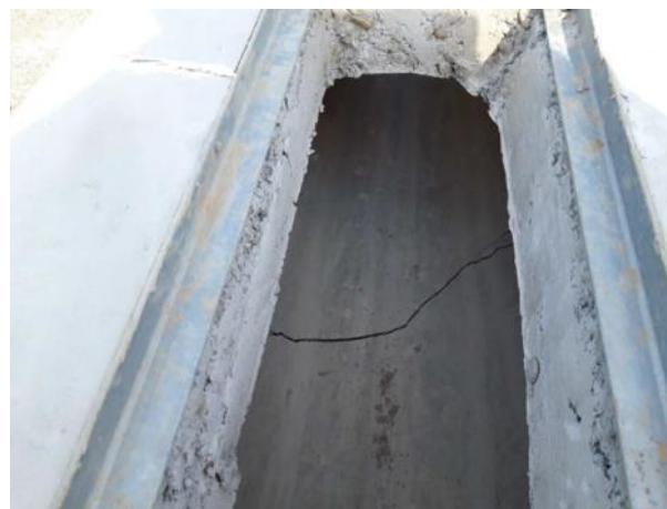
Chambre avec fissure @SIGNATURE
