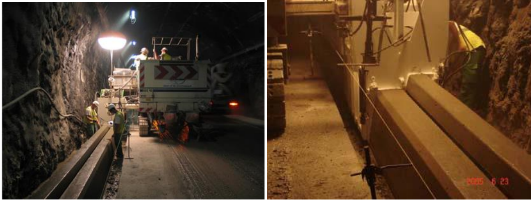
CAF en tunnel @AGILIS
